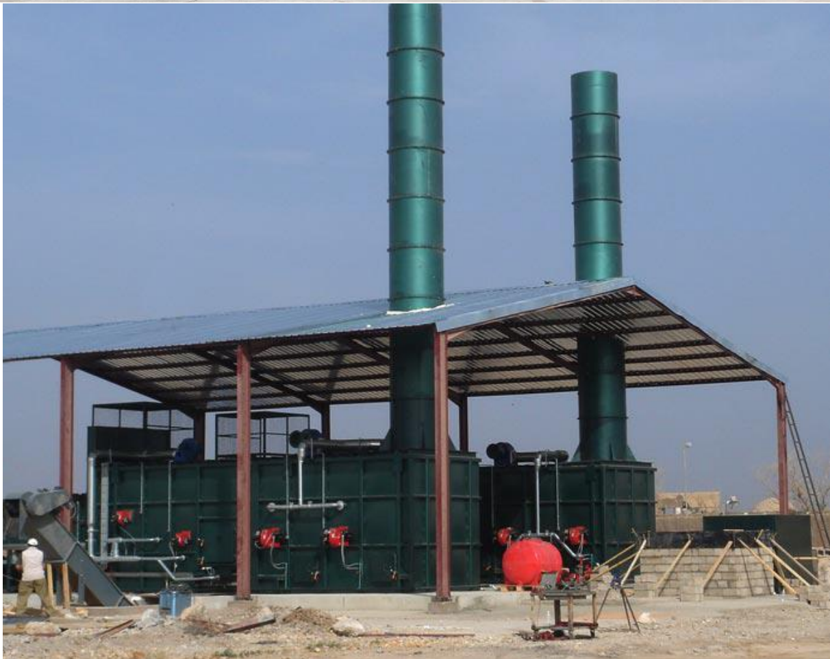
Photo 7. Incinérateur à deux chambres de combustion.
