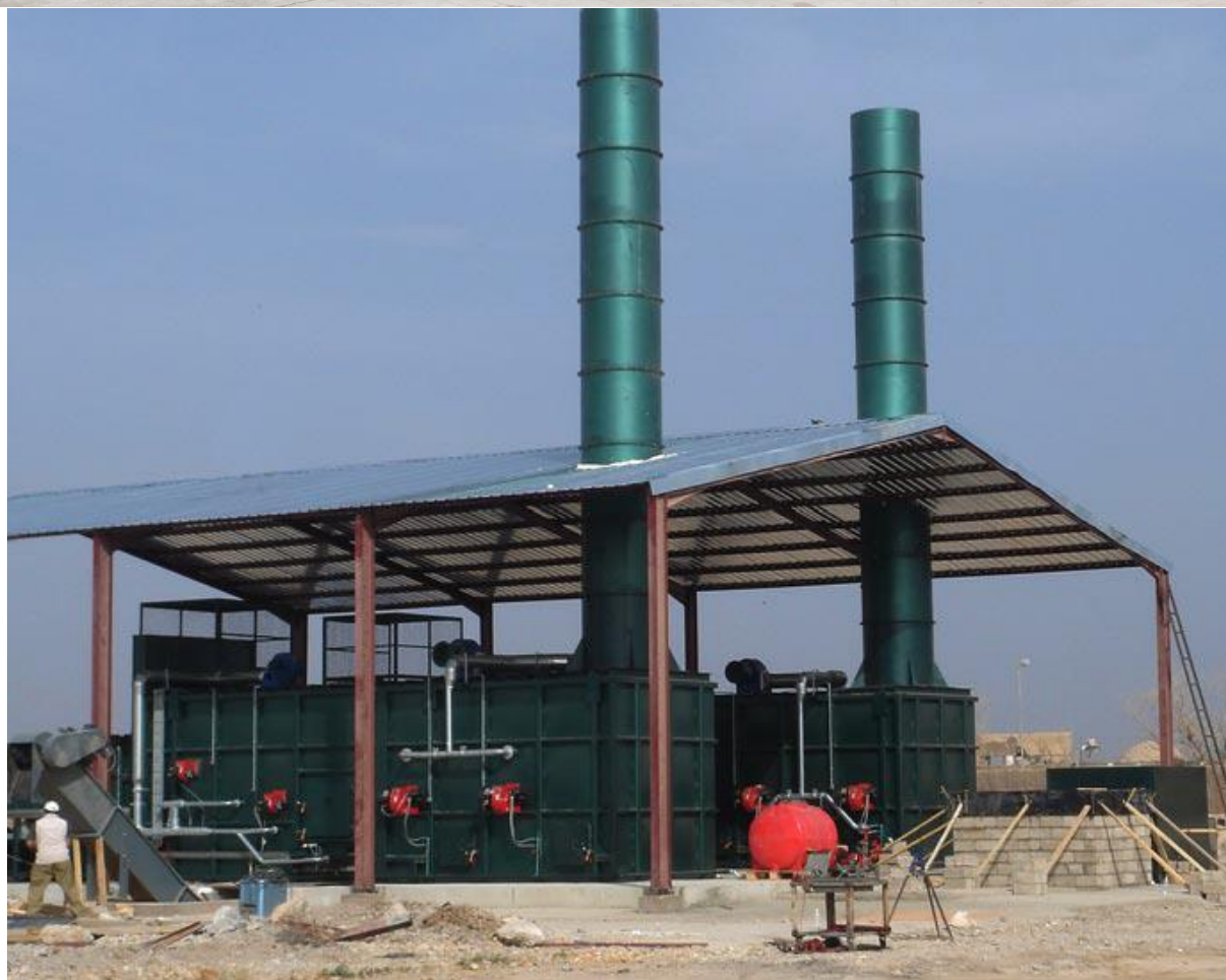
Photo 7. Incinérateur à deux chambres de combustion.
